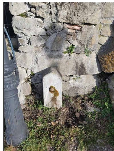
Fuente asociada que está obstruida.
